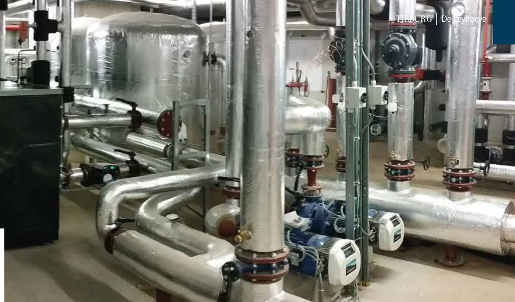
In totaal is 800 kW aan lage temperatuur warmtepompen voor verwarming en koeling opgesteld en 300 kW aan hoge temperatuur warmtepompen.
